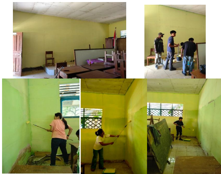
Gambar 1. Kondisi Ruang Kelas Sebelum Revitalisasi
